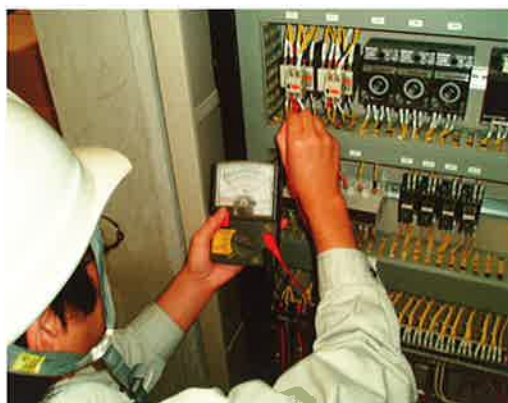
定期点検（電圧測定）
