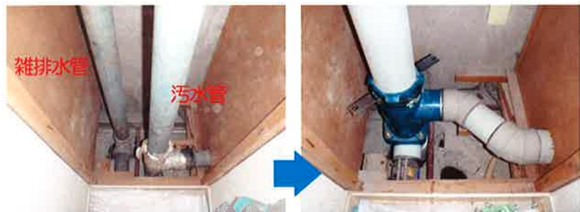
排水システムの変更 汚水・雑排水分流式から排水用特殊継手を利用して合流方式へ変更
