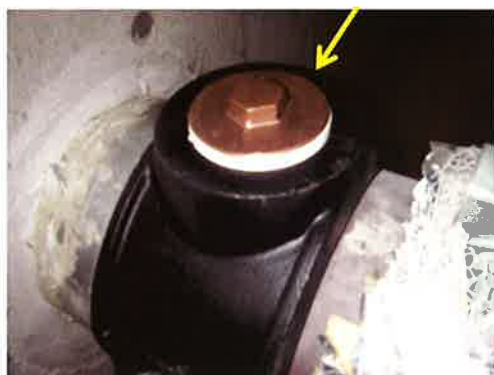
竣工後、立て管接続部直近で ディスポーザ系統横枝管に 清掃用の掃除口を設置（矢印）
